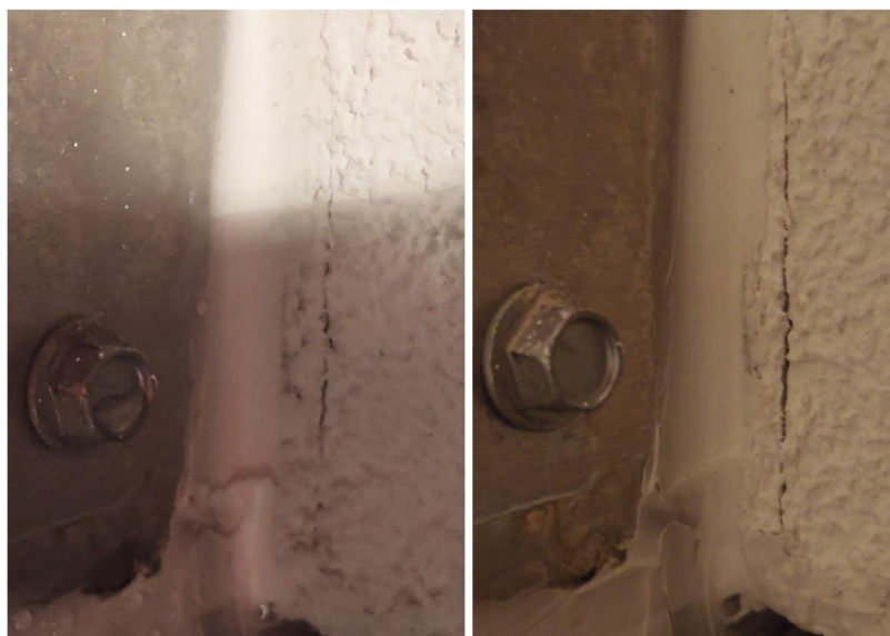
Kuva 3.4. Ikkunapielissä esiintynyttä halkeilua.
